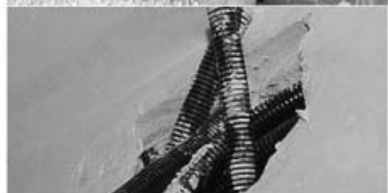
Humedades y malos acabados, los grandes pecados capitales de los 'malos' constructores.
